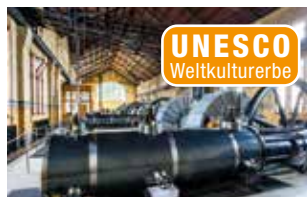
Besichtigung im Wouda-Pumpwerk
